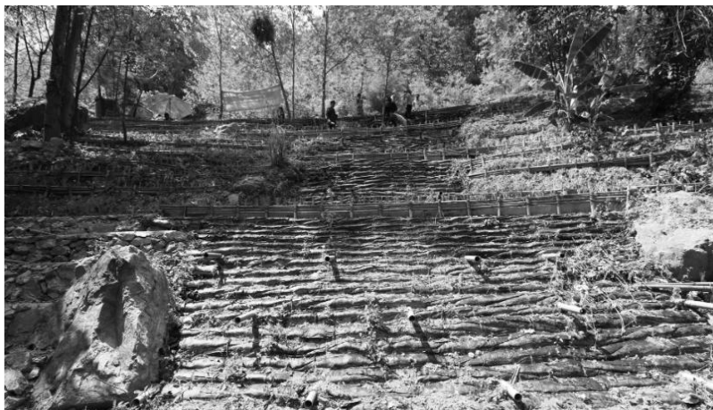
รูปที่ 7.5-2 รูปแบบก่อสร้างลาดคันทางดินเสริมกำลัง
